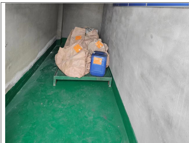
危废暂存间地面防渗及铁托盘
