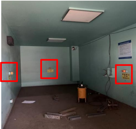
铅房内紧急停机按钮
